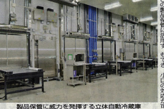
製品保管に威力を発揮する立体自動冷蔵庫
